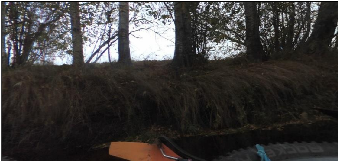
Kuva 5. Teuronjoen penkassa havaittu pienehkö syöpymä.
