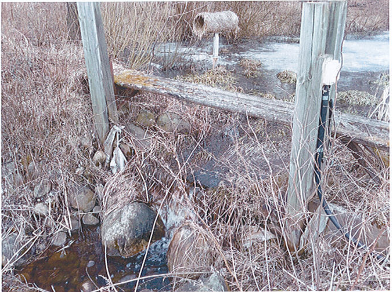
Kuva 11. Altaan vanha pato. Patoa voisi kunnostaa vaihtamalla lankkuja ja siistimällä kiveystä.
