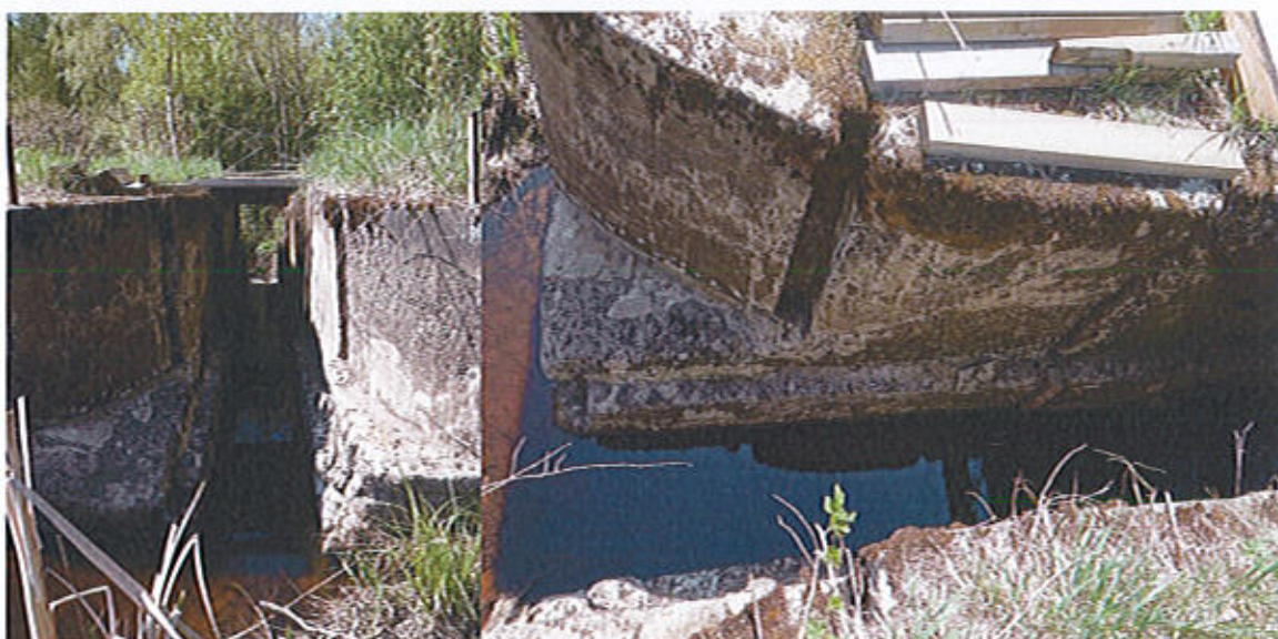
Kuva 5. Tyhjennyskanava on valettu sementistä ja kaipaa paikkausta. Vedenkorkeutta on säädelty lankuilla, joille on valettu urat kanavaan. Varsinainen lankku-ura sisempänä padossa.
