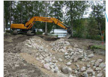
Kalatie Oriharonjärvelle rakennetaan tekemällä uusi pohjapato vanhan säännöstelypadon viereen. Jatkossa kalat pääsevät kulkemaan esteettä padon ohi.
